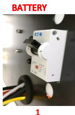
Figura 3 - Quadro elettrico M.STORE
